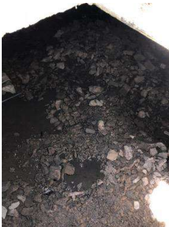
Figura 23 - Foto interna da caixa d'água do castelo – danos da impermeabilização
