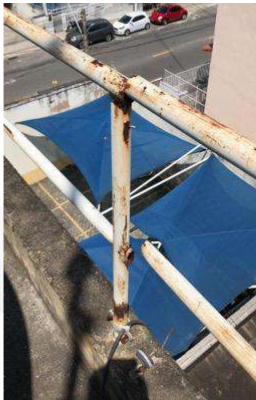
Figura 25 – guarda-corpo danificado e enferrujado
