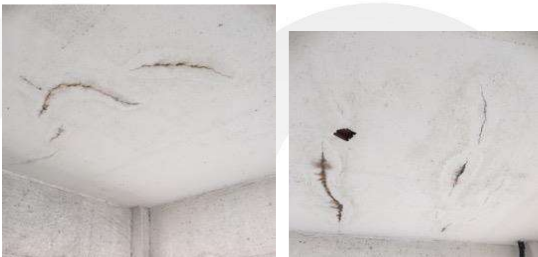
Figuras 30 e 31 – fissuras
