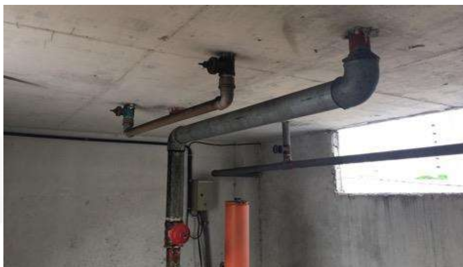
Figura 16 - Trechos de tubulações de incêndio (saída da caixa d'água)
