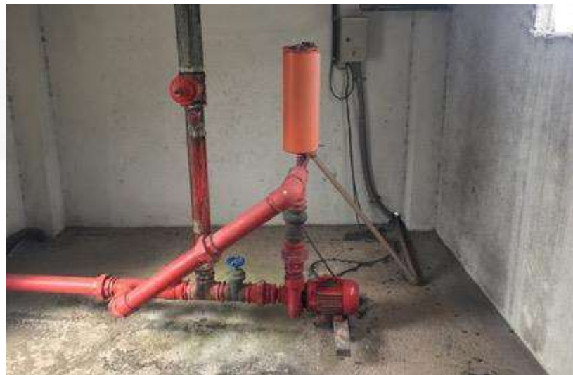
Figura 14 – Bomba de incêndio
