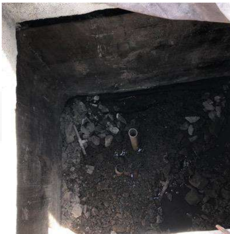
Figura 22 - Foto interna da caixa d'água do castelo – danos da impermeabilização
