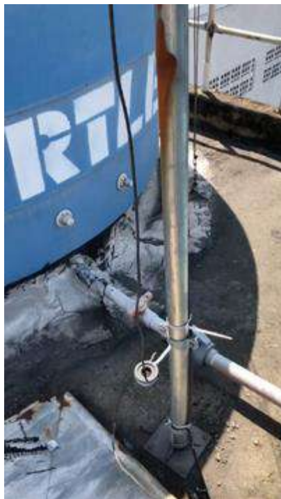
Figura 7 – Haste metálica do pára-raio com início de ferrugem
