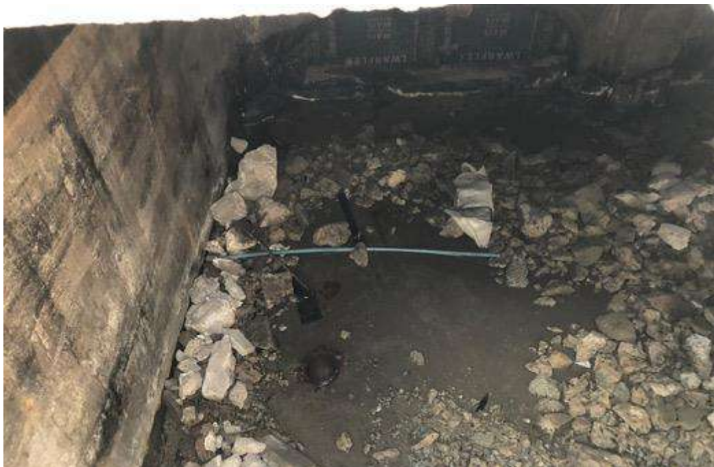
Figura 21 – Foto interna da caixa d'água do castelo – danos da impermeabilização
