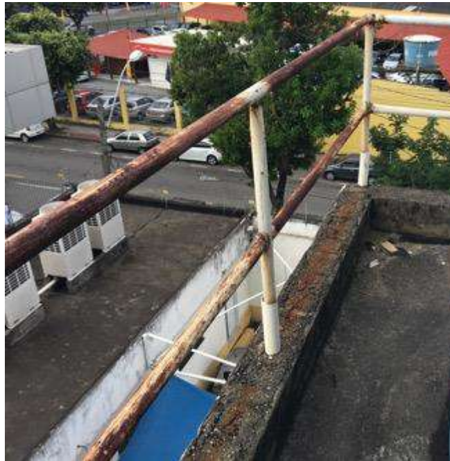
Figura 26 - guarda-corpo com corrosão
