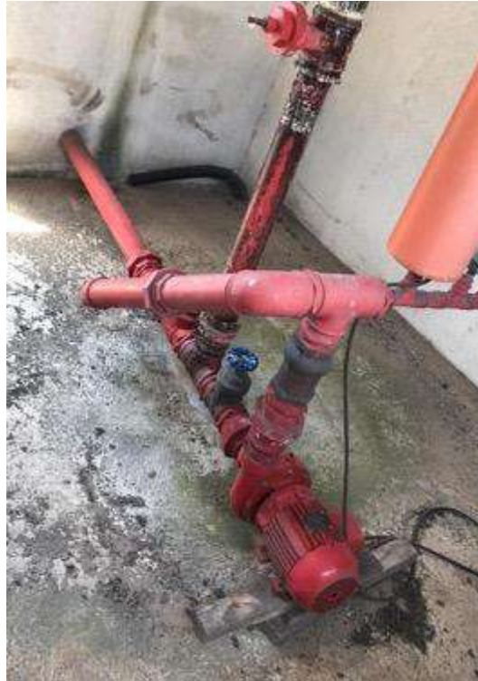
Figura 17 – bomba de incêndio sem base adequada
