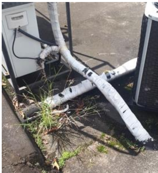
Figura 52 – instalações de ar condicionado
