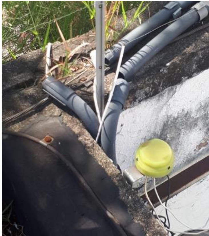
Figura 53 – cerca elétrica/ alarme
