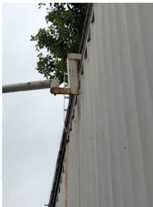
Figura 50 – estrutura metálica da garagem danificando o portão
