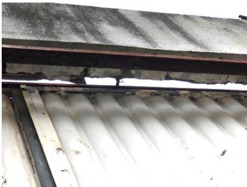
Figura 69 – viga de concreto estrutural com patologia
