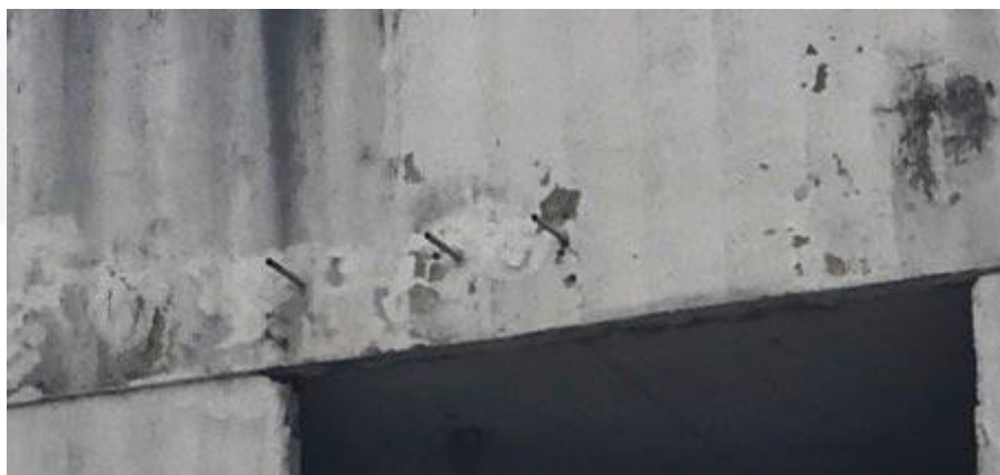
Figura 39 – tubos estranhos chumbados na parede da Caixa d' água
