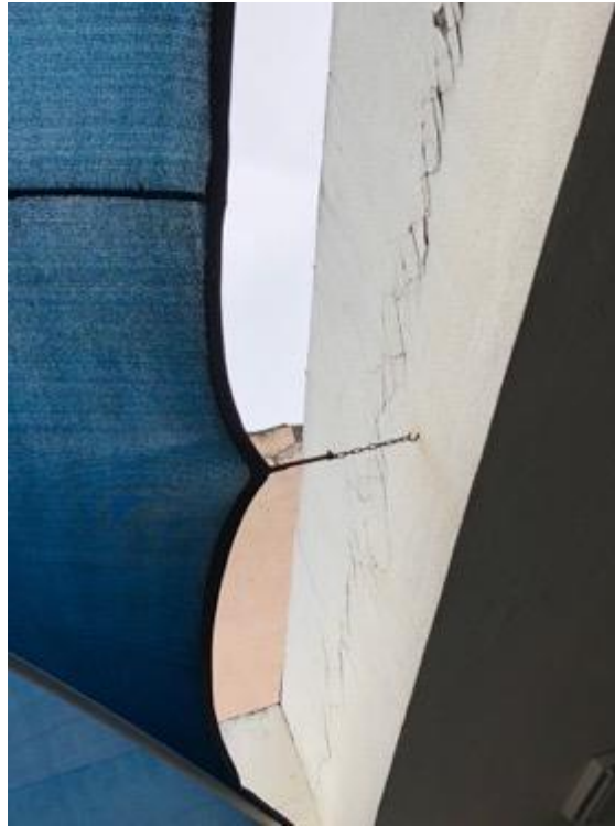
Figura 65 – Trinca na estrutura da laje técnica
