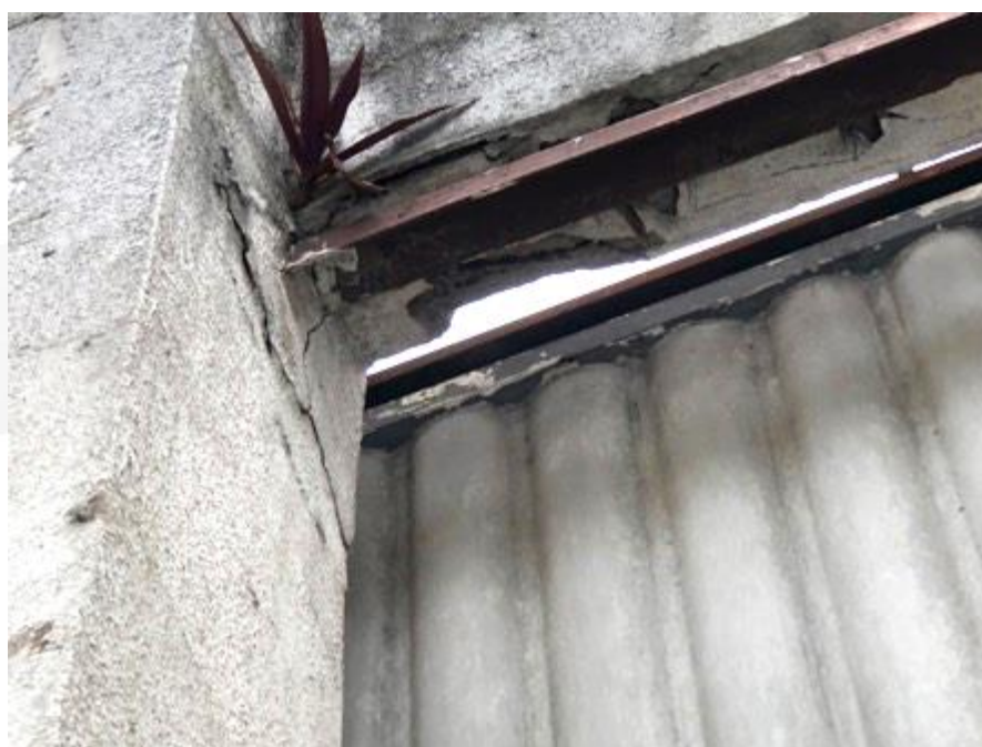
Figura 59 – peça metálica externa corroída e se soltando do lado esquerdo
