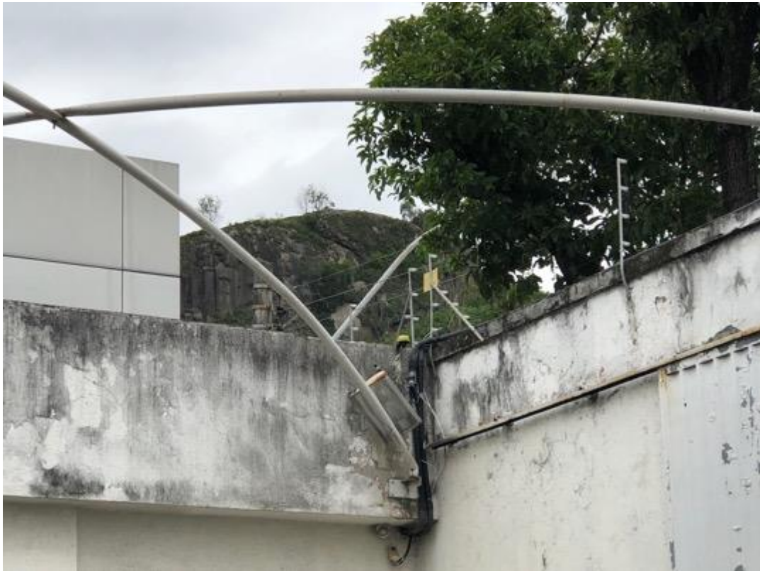
Figura 51 – Trechos da cobertura sem lona
