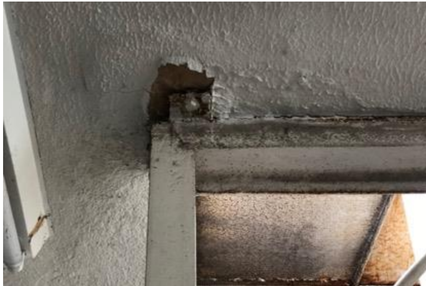
Figura 47 – Ponto de fixação da escada danificado
