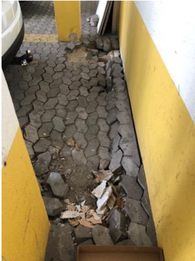
Figura 63 – trechos do piso da garagem afundado
