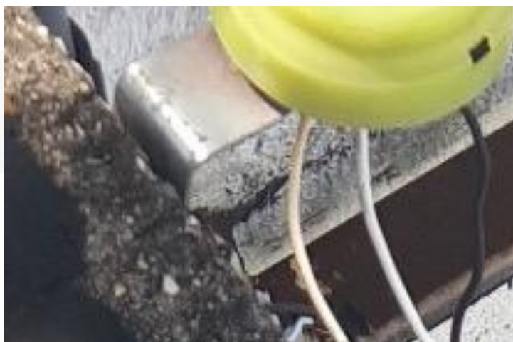
Figura 54 – fio desencapado e inapropriado
