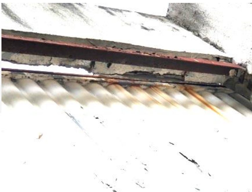
Figura 70 – viga de concreto estrutural com patologia
