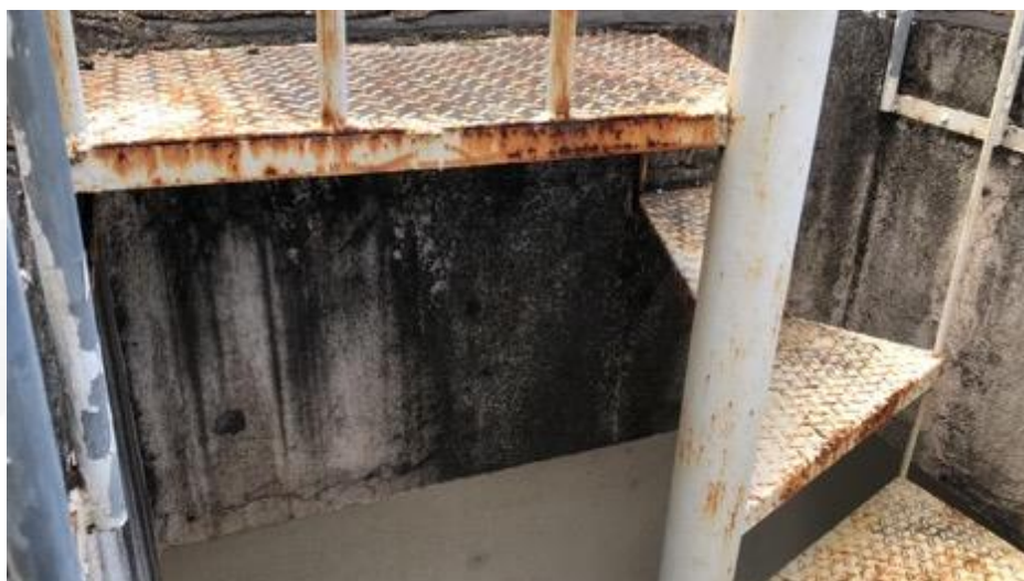
Figura 46 – escada enferrujada/ corroída
