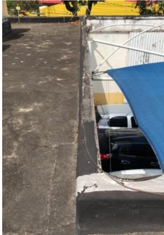
Figura 55 – perímetro sem proteção contra queda de guarda-corpo
