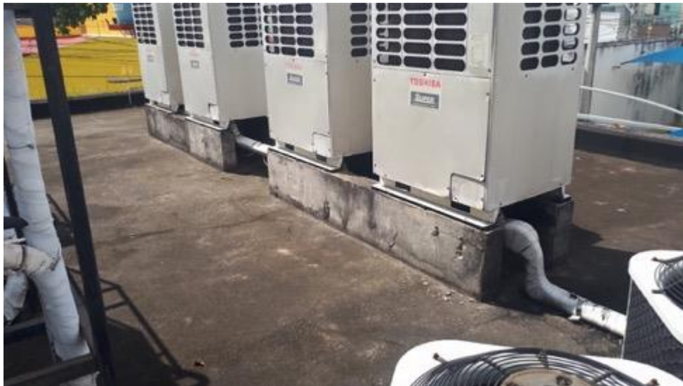
Figura 71 – base das condensadoras de ar condicionado com patologia
