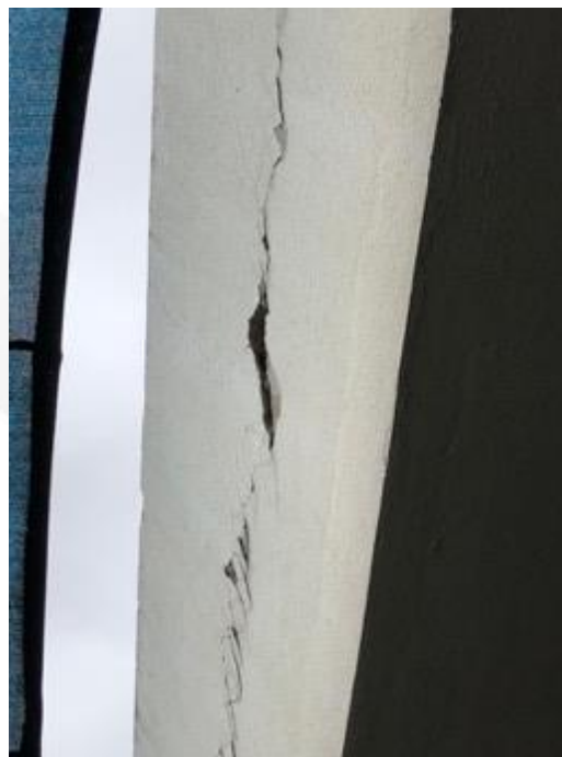
Figura 66 – trinca na estrutura da laje técnica
