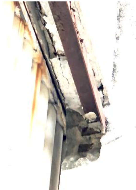
Figura 58 - peça metálica externa corroída e solta do lado direito
