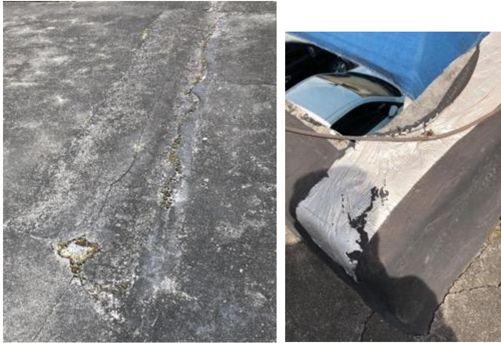
Figuras 40 e 41 – proteção da manta danificada
