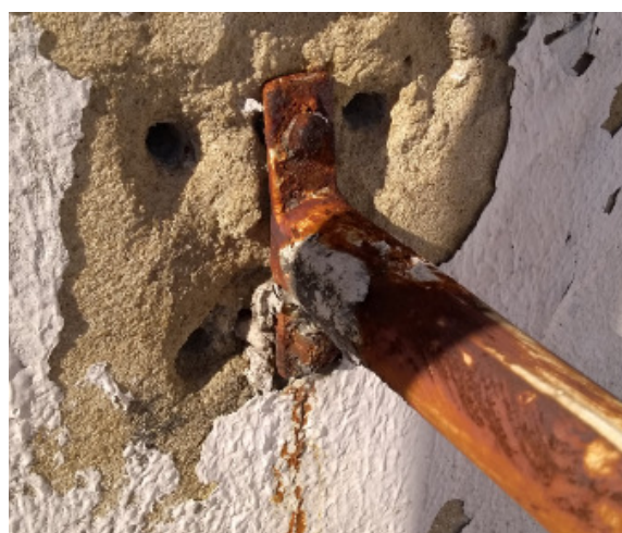
Imagens 19 e 20 – Deterioração de chumbadores da escada marinho
