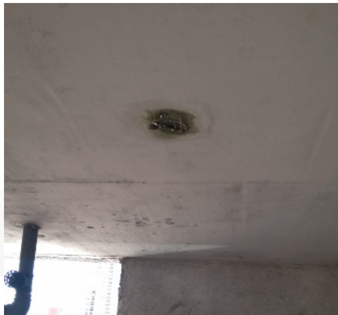
Imagem 12 – Ponto de infiltração na laje piso da caixa d'água, abaixo da caixa de fibra de 20.000L.
