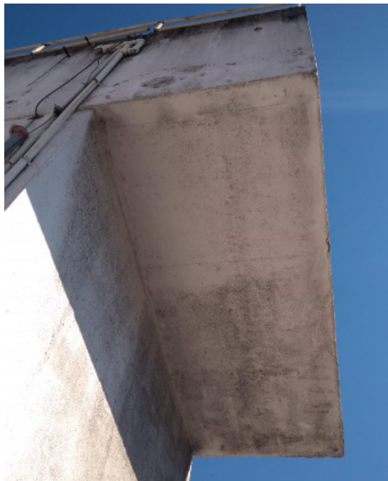
Imagem 11 – Laje em balanço da caixa d'água vistoriada.
