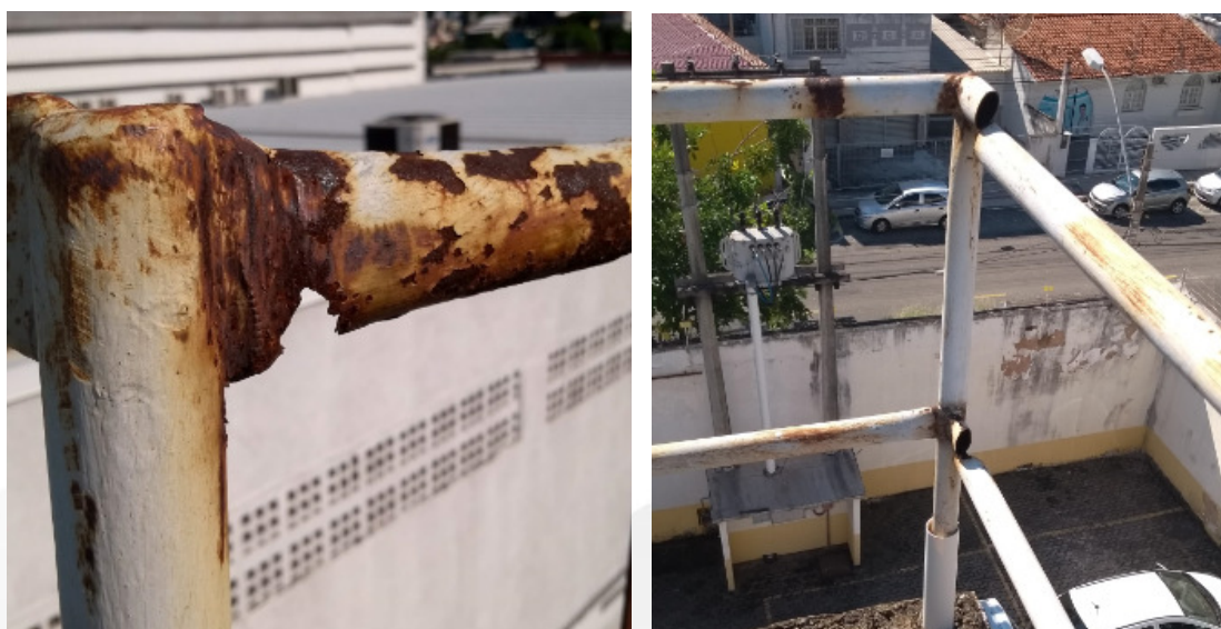
Imagens 17 e 18 – Deterioração de guarda-corpo.
